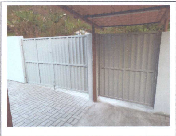
PORTAO METALICO INCLUSIVE PINTURA
