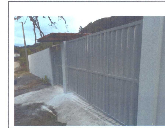
PORTAO METALICO INCLUSIVE PINTURA
